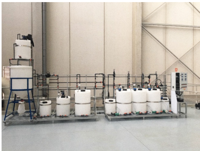
Figura 11. Planta piloto en las instalaciones de Pavagua
