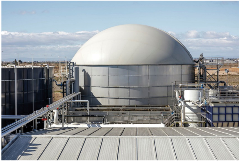
Figura 3. Planta de digestión anaerobia para producción de biogás en Zuvamesa (imagen cedida por Zuvamesa)
